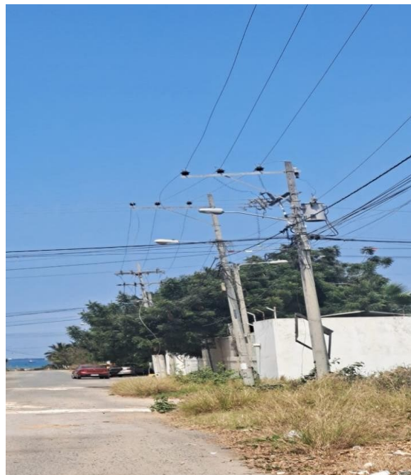
Figura 21. Líneas de distribución eléctrica
