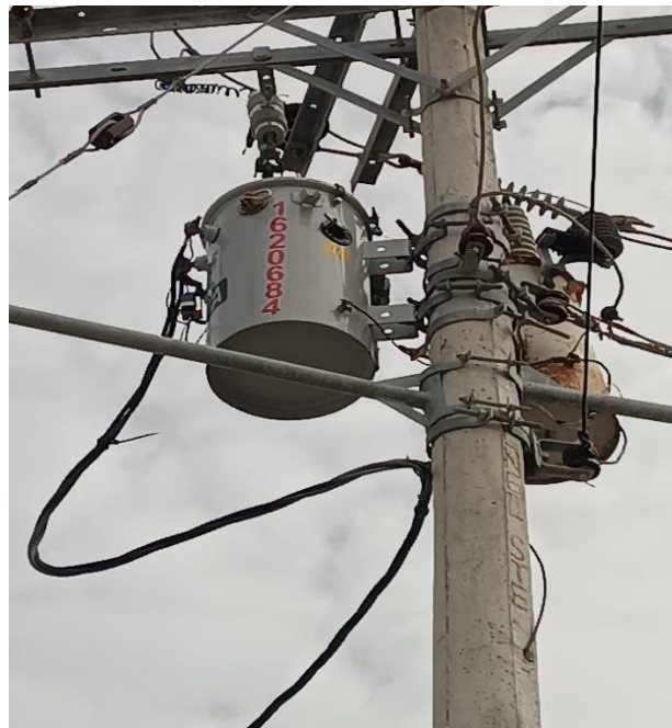
Figura 40. Transformadores de distribución de sector
