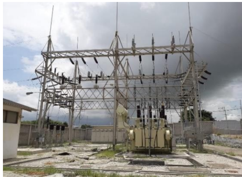
Figura 19. Subestación La Libertad
