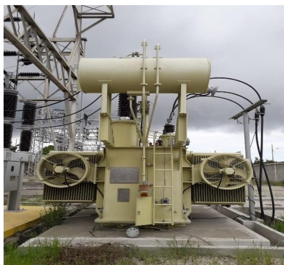
Figura 32. Transformador de potencia de la subestación La Libertad
