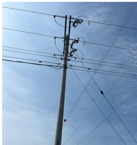
Figura 36. Líneas de distribución de media tensión (13.8kV)
