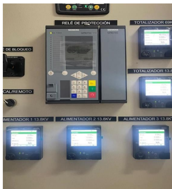
Figura 34. IEDs de medición y protección
