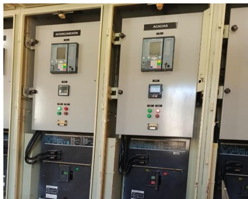
Figura 20. Tablero de medición, protección, interruptor de potencia alimentadores
