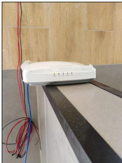
Figura 74 Instalación de AP. Autor: Nevison Escudero – John Del Pezo
