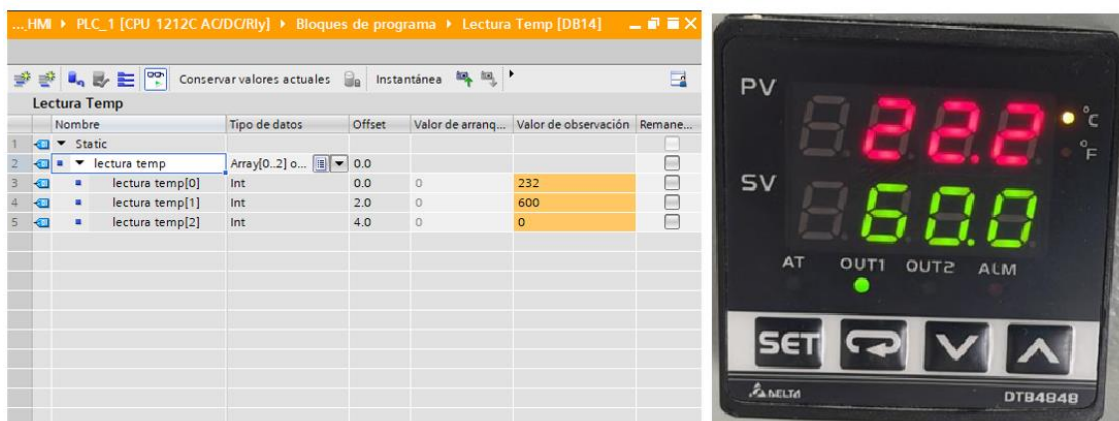
Figura 42 Comunicación en tiempo real entre controlador de temperatura y autómata programable S7-1200. Fuente: Autor
