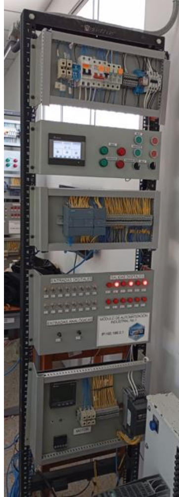
Figura 19: Tablero de control
