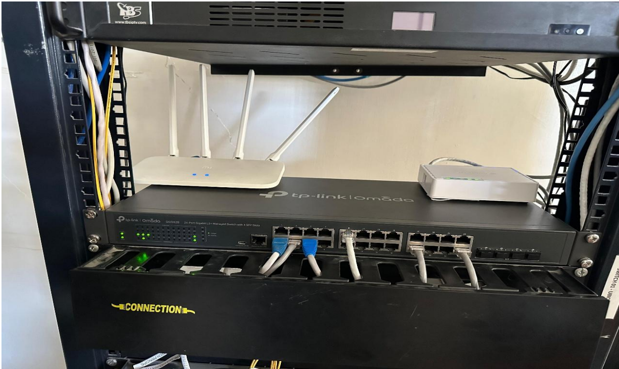
Figura 105. Equipos instalados en el rack 4.
