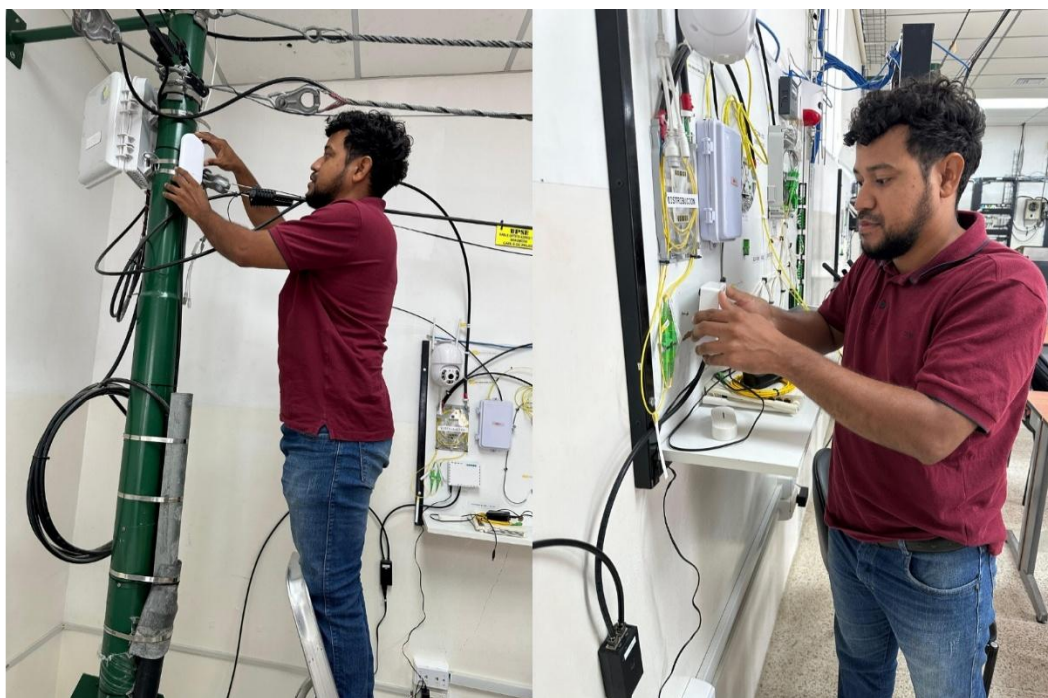
Figura 107. Colocación de la antena CPE y del router para habilitar la conexión del usuario estándar.
