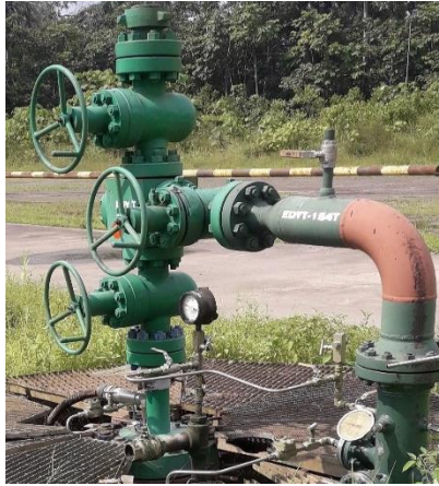
Figura 5. Cabezal del Pozo EDYT-154 Campo Edén Yuturi.
