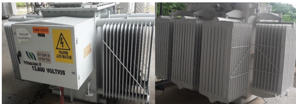
Figura 6. Transformadores; d, Reductor; i, Elevador, campo Edén Yuturi.
