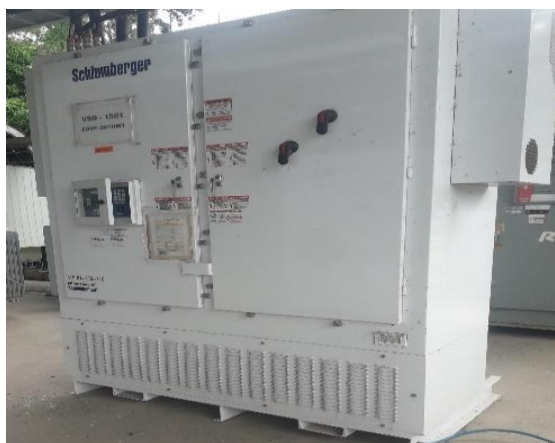
Figura 8. Variador de frecuencia, campo Edén Yuturi.
