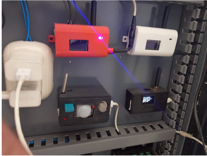
Figura 26: Nodos instalados para la comunicación con Node-RED
