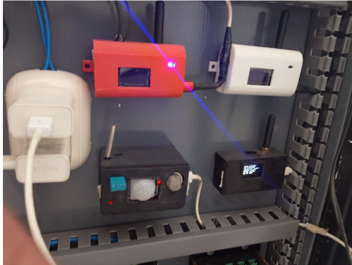
Figura 10: Módulos instalados en el laboratorio
