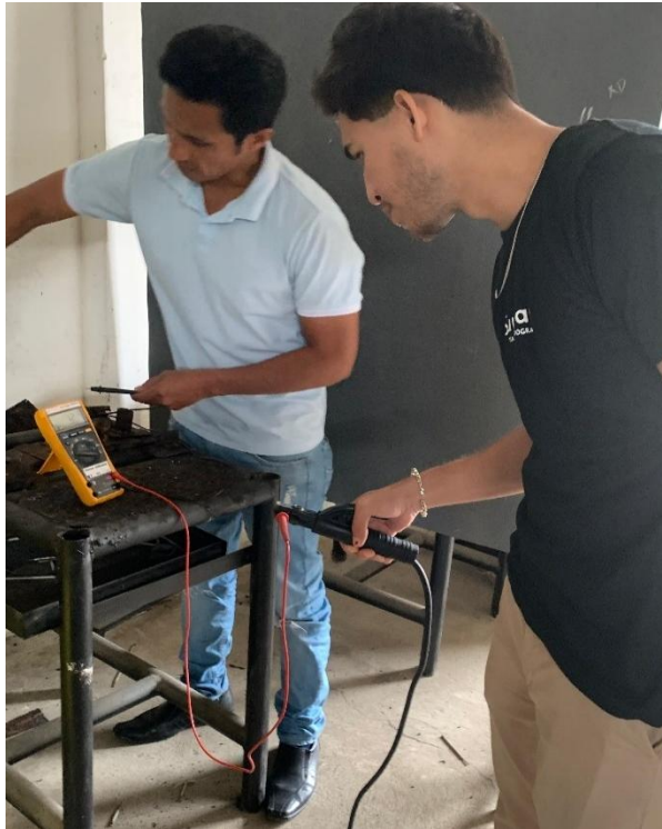
Figura 23. Verificación de equipos.
