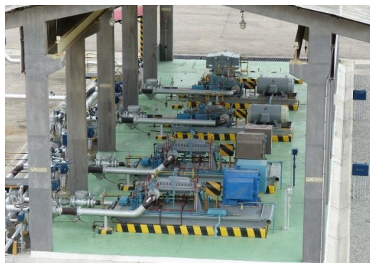
Figura 14: Estación de bombeo Cabecera La Libertad.
