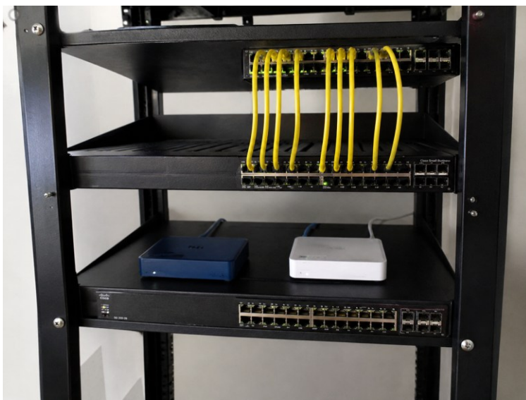
Anexo 3. Mikrotik Administrador junto con el Switch expansión de puertos para los módulos.
