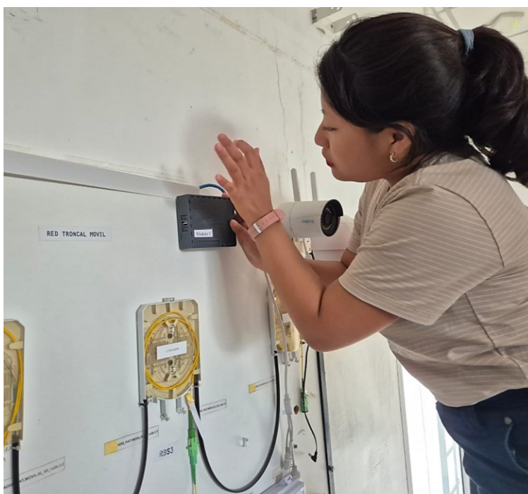
Anexo 4. Instalación de los módulos, para la arquitectura de la red.
