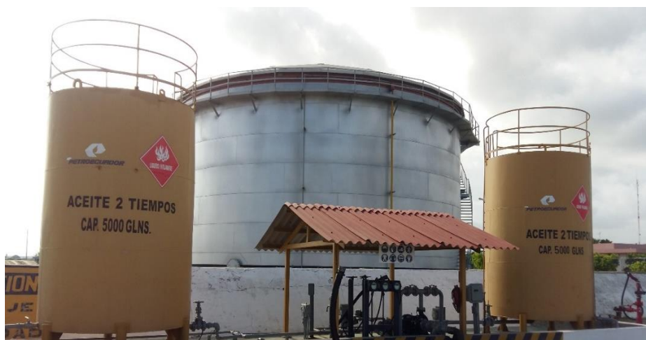
Figura N° 32 Tanques verticales de almacenamiento de aceite de dos tiempos.
