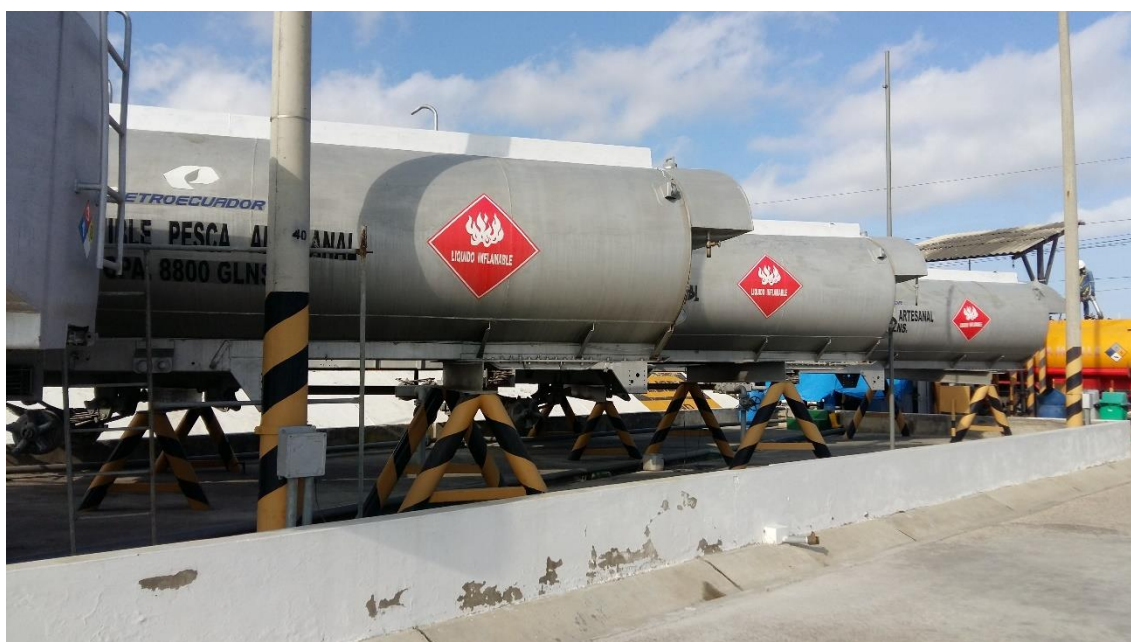
Figura N° 35 Tanques de almacenamiento de combustible de G.P.A.
