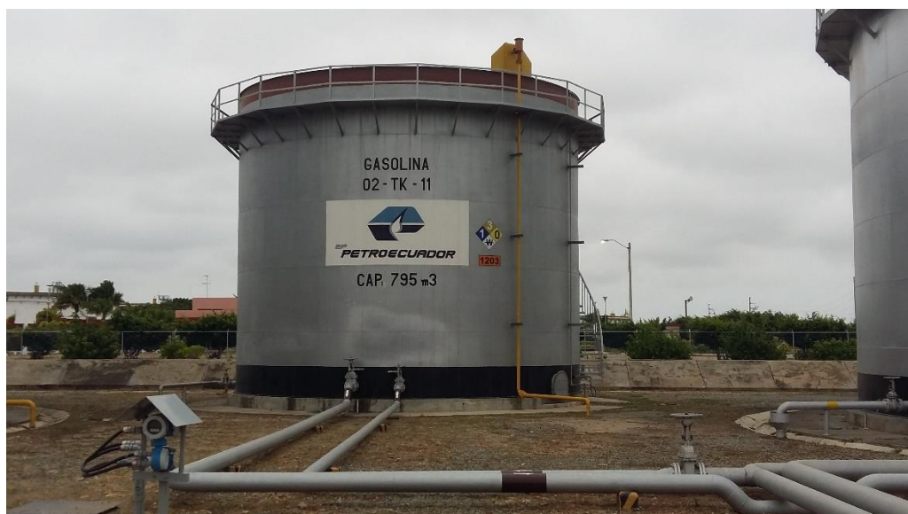
Figura N° 34 Tanque flotante TK-11 de almacenamiento de gasolina base.
