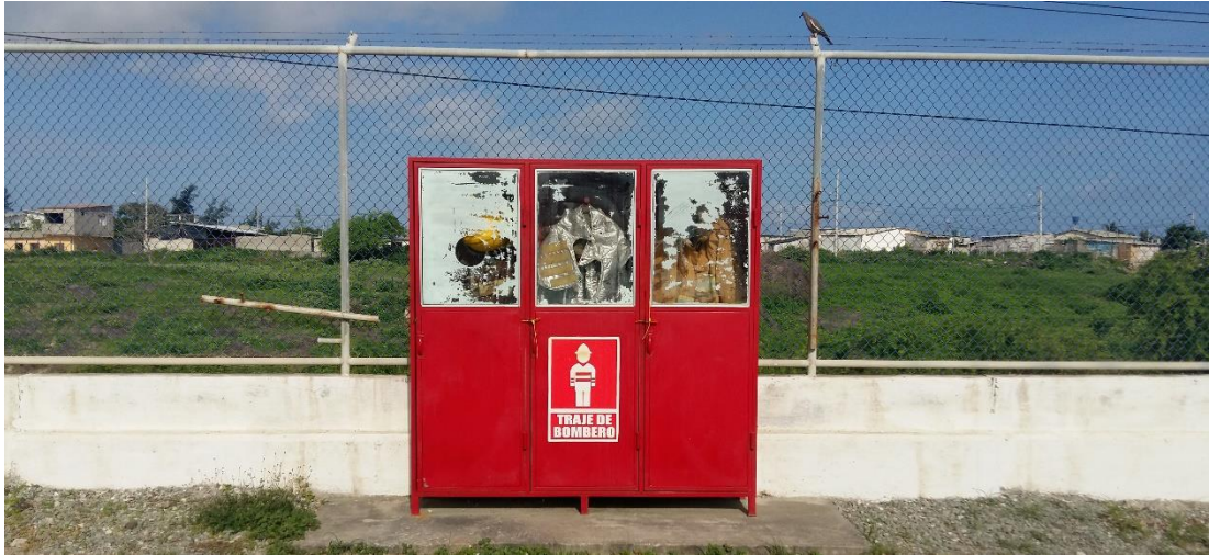
Figura N° 16 Sistema contra incendio SCI.
