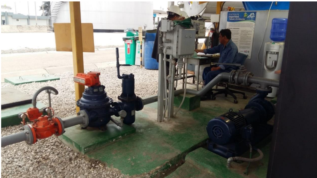
Figura N° 15 Estacion de bombeo.
