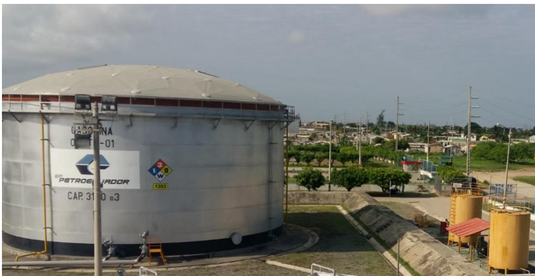
Figura N° 19 Tanques de almacenamientos.
