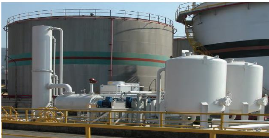
Figura N° 29 Unidad Recuperadora de Vapor
