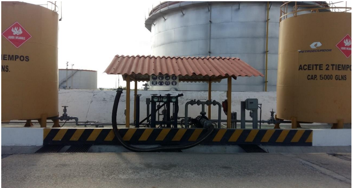
Figura N° 37 Estación de recepción de aceite de dos tiempos.
