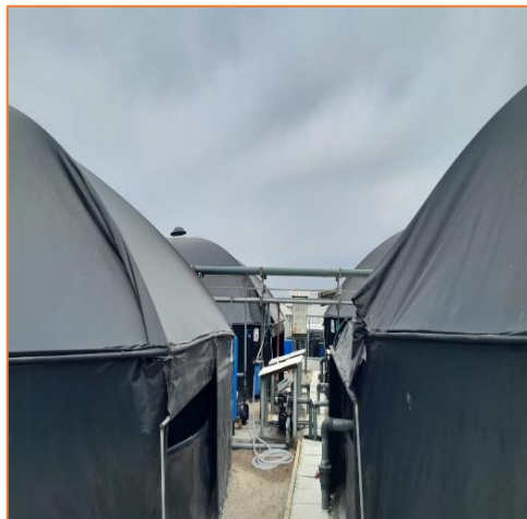
Figura 13 Planta de osmosis inversa 1
