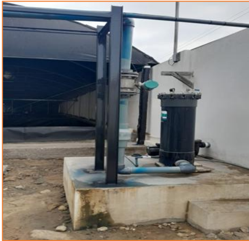
Figura 11 Descarga de agua de Pozo
