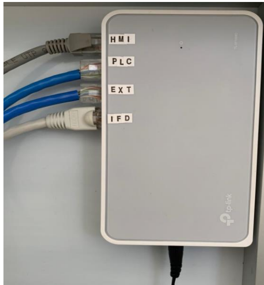
Figura 44. Conexión de los puertos Ethernet del switch TP-Link Fuente: Autoría propia.
