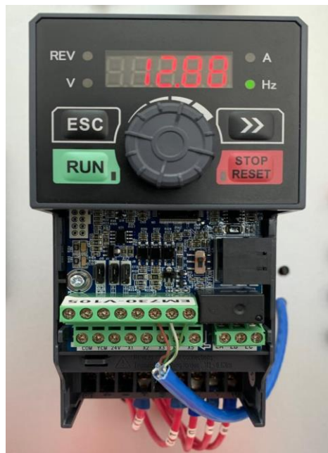
Figura 35. Conexión del variador de frecuencia SINEE. Fuente: Autoría propia.
