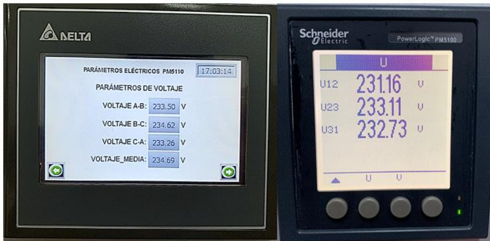
Figura 94. Monitoreo de parámetros eléctricos de voltajes de forma física a través del HMI DOP-103WQ y el medido PM5110. Fuente: Autoría propia.
