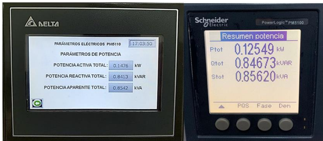
Figura 96. Monitoreo de parámetros eléctricos de potencias de forma física a través del HMI DOP-103WQ y el medido PM5110. Fuente: Autoría propia.
