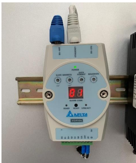
Figura 41. Conexión del convertidor Delta IFD9506. Fuente: Autoría propia.
