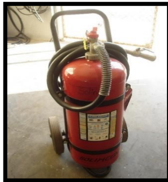
Imagen 3.23. Extintor de fuego A,B,C
