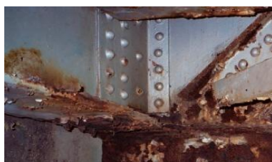
Ilustración 30. Deterioro por corrosión en una unión metálica estructural con pérdida de sección y daño en los elementos de acero.
