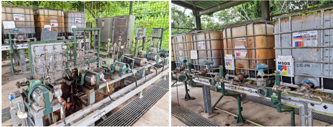
Ilustración 3. Skid para inyección de química antiescala y anticorrosivo SHSI-119
