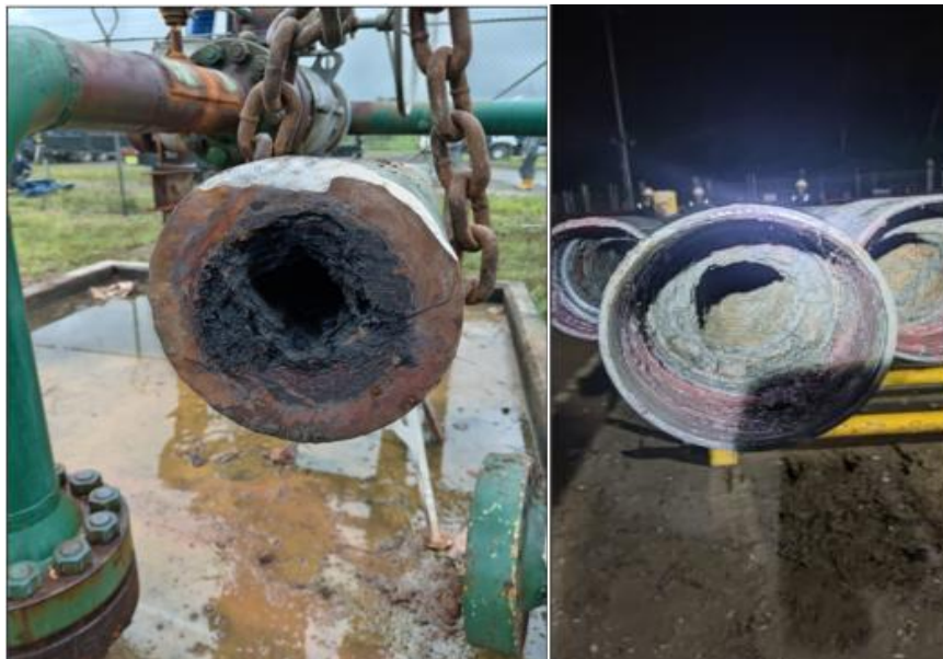
Ilustración 16. Escala y sulfuros taponando línea de superficie
