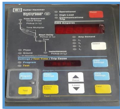
Figura 24: Relé de protección: Cnel Ep
