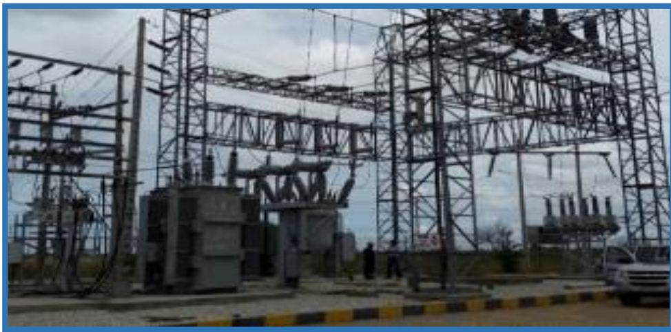
Figura 2: Subestación de distribución Chanduy : CNEL EP
