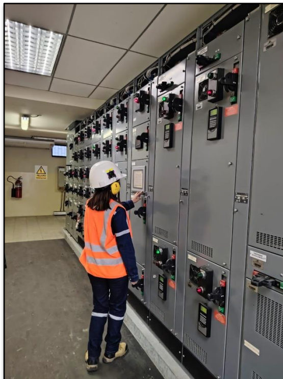
Revisando equipos y paneles de control de las instalaciones al interior de la Refinería La Libertad .
