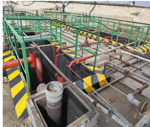
Figura 30: Estructura del separador API #3
