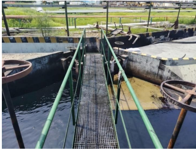
Figura 11: Separador API #1- Primer Etapa
