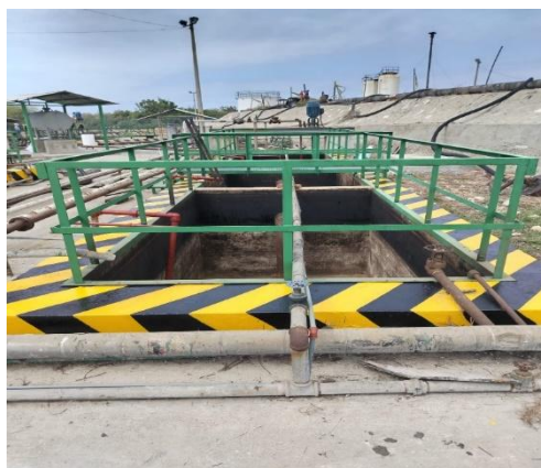
Figura 31: Separador API #3 limpio
