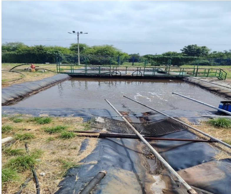
Figura 21: Piscina de geomembrana
