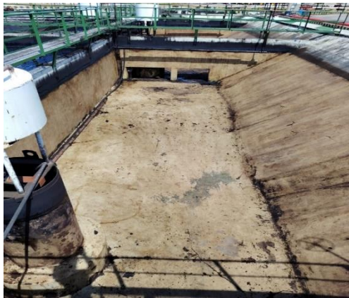
Figura 27: Separador API #1 limpio
