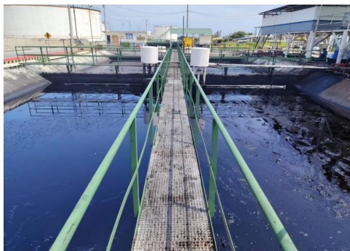
Figura 12: Separador API #1- Segunda Etapa
