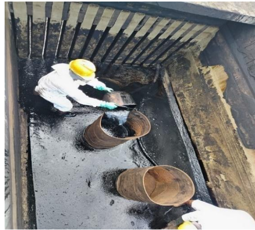
Figura 29: Recolección de sedimentos en tanques metálicos en API #2
