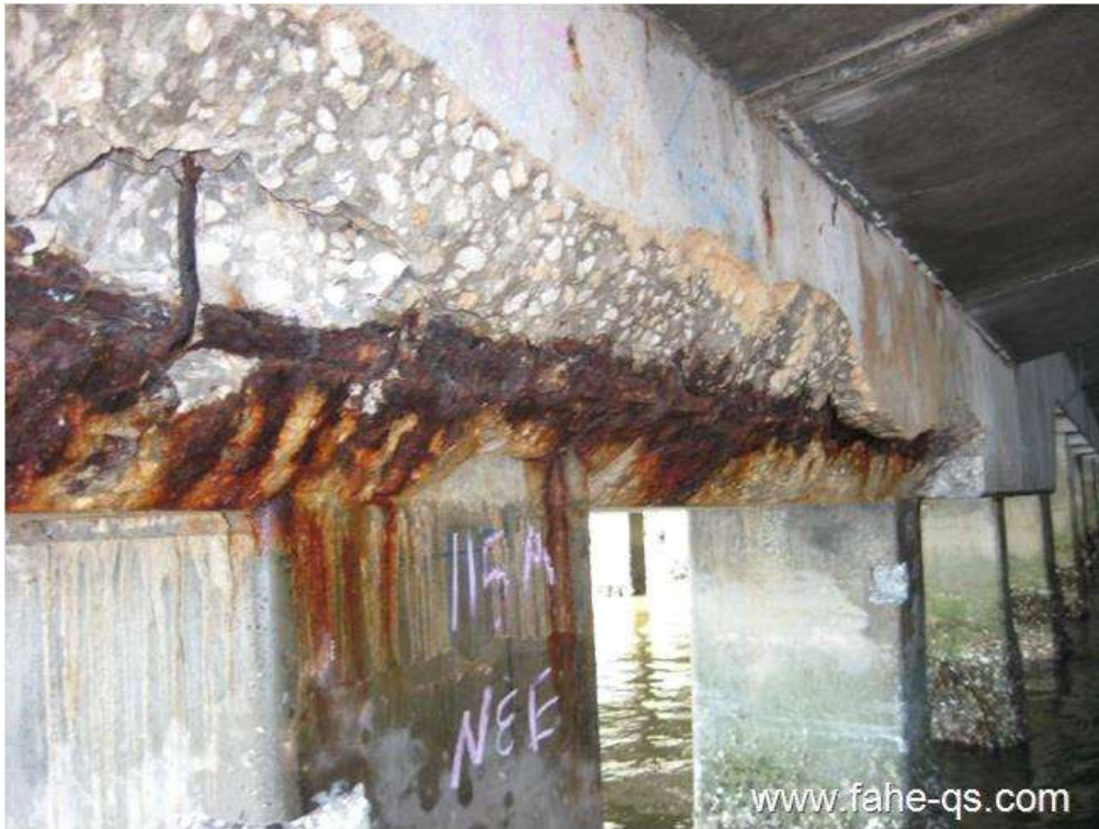
Figura 14. Evaluación de daños estructurales en infraestructura vial.
