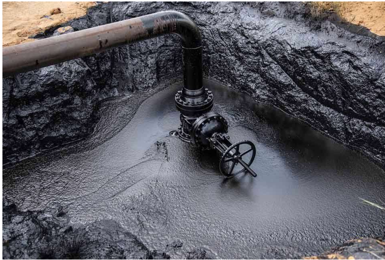
Figura 12. Derrame de petróleo en Monagas causado por instalación de tubo defectuoso
