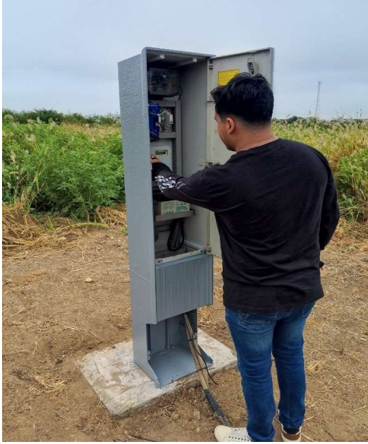
Nota: Verificación de caudal
