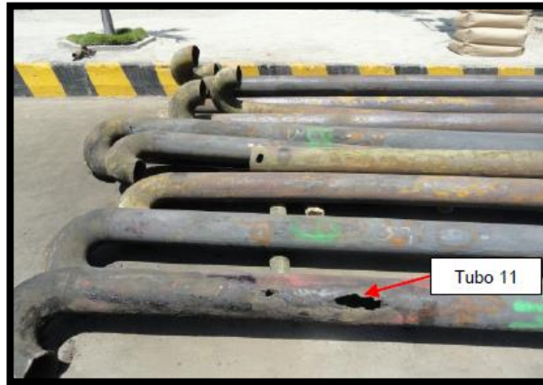
Figura 24. Tubería con ruptura
