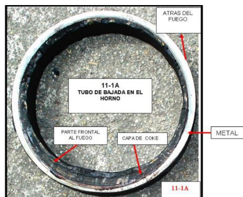
Figura 25. Incrustaciones de coque en la tubería.
