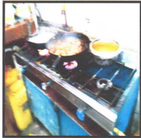
Utensilios de cocina en mal estado
