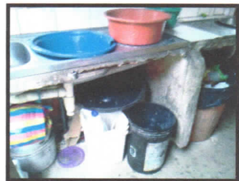
Lava platos en mal estado
