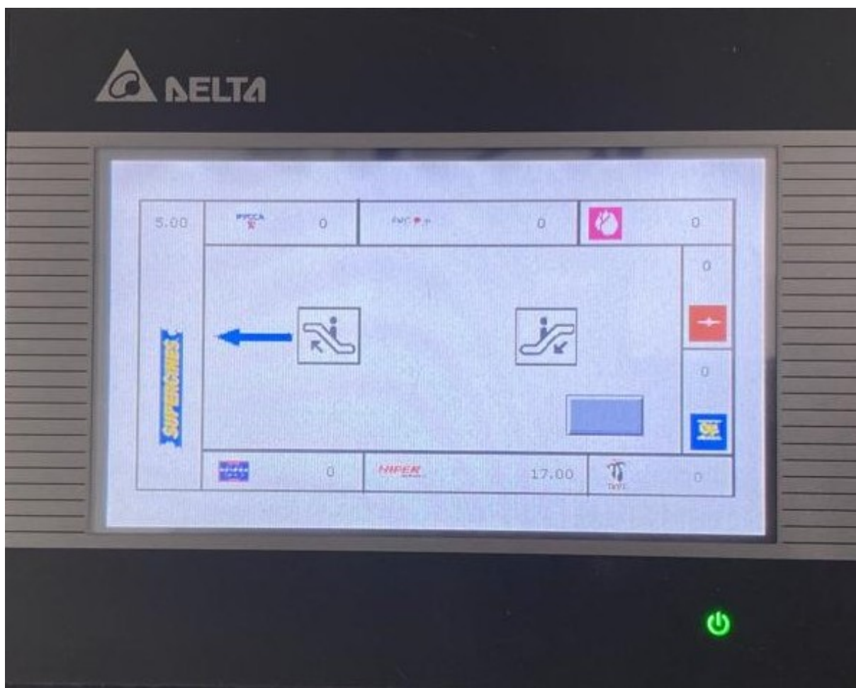
Figura 27: Prueba del sistema en HMI
