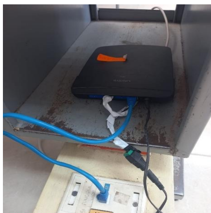
Figura 18 - Conexión de la cámara con el router
