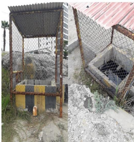
A) Cubeto de contención para la emanación.
