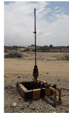
D) Pozo SPA 240.
