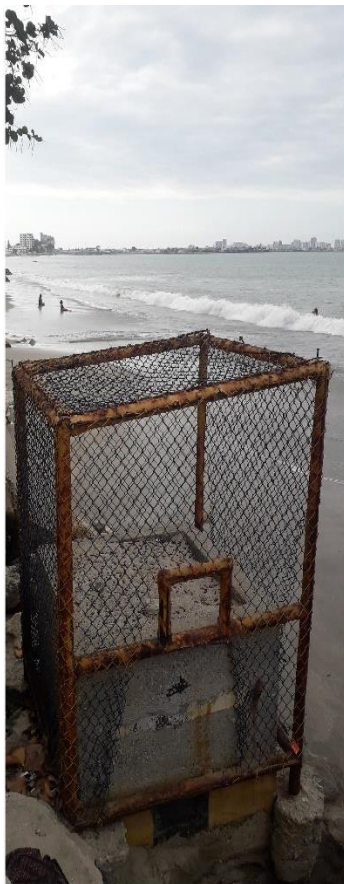
A) Cubeto de contención.
