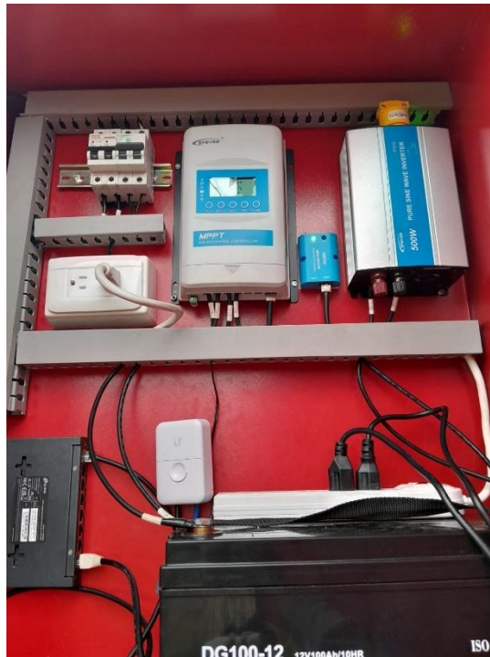
Figura 3. 6: Gabinete de control del sistema fotovoltaico instalado en el portón principal.
