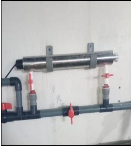
Anexo 4. Instalación de lámpara UV
