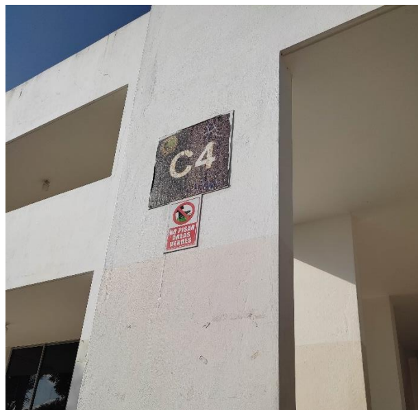
Figura 21. Condición de las señaléticas en la UPSE
