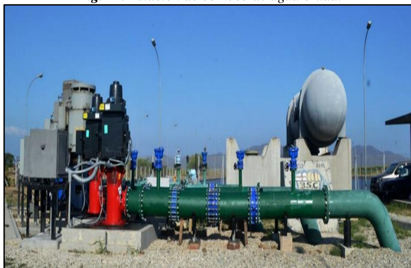
Fig. 12. Estación de bombeo de agua cruda.
