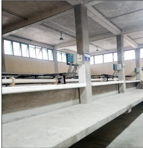
Tolvas de preparación del coagulante.
