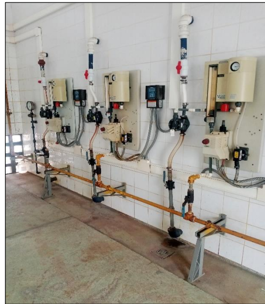
Dosificadores de cloro gas.
