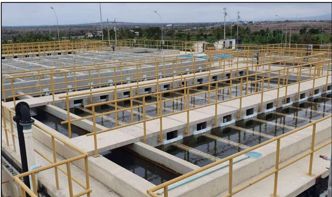
Fig. 16. Módulos de potabilización MPA.
