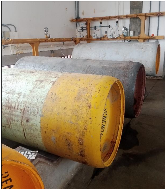
Cilindros de gas cloro 907 Kg.
