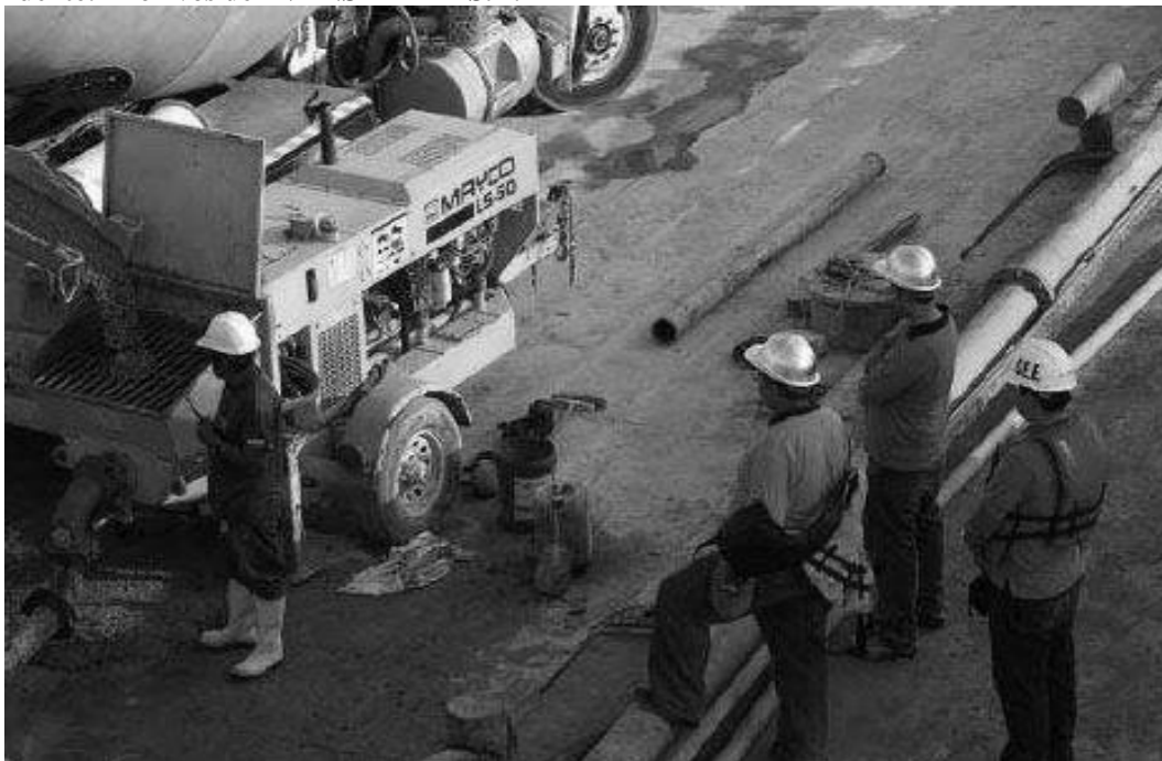
Operarios en la construcción de una iglesia de las Asambleas en La Libertad
