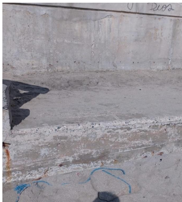
Figura 11: Evidencia de que no existe un desnivel en la rampa
