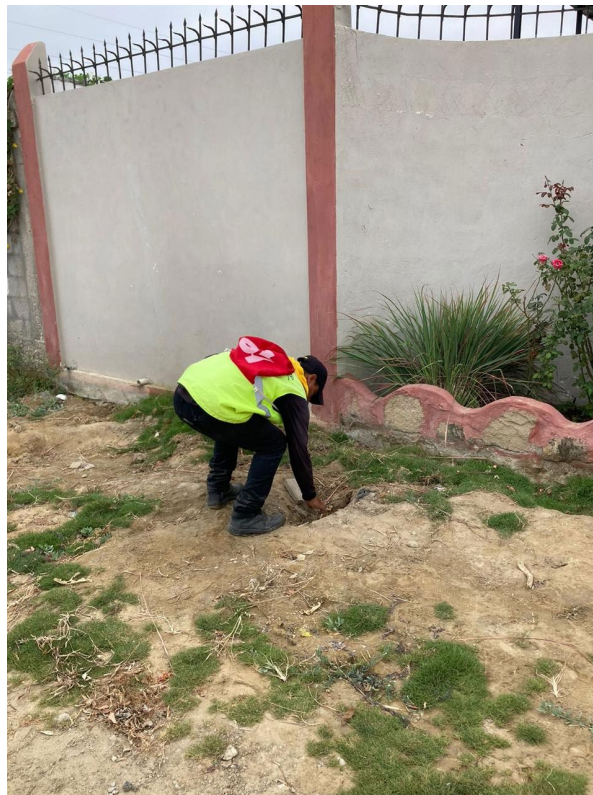
Anexo A 6 toma de lecturas a micromedidores
