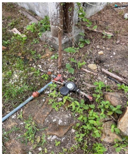
Nota: Punto de abastecimiento de agua para toda la ciudadela.
