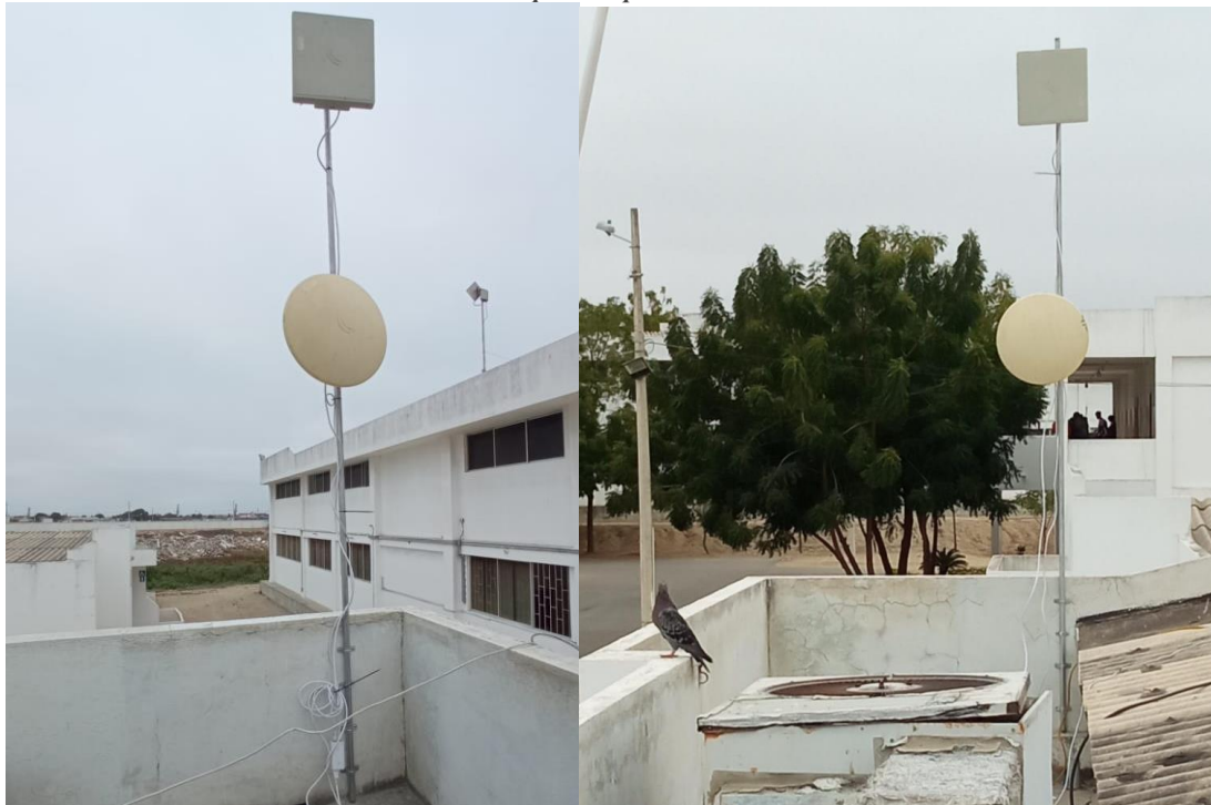
Anexo 2. Ubicación de las antenas Mikrotik en los exteriores de los laboratorios de Facsistel para la comunicación punto a punto
