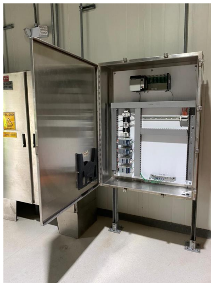
Fig. 12. Montaje y conexión del PLC-GW-40000
