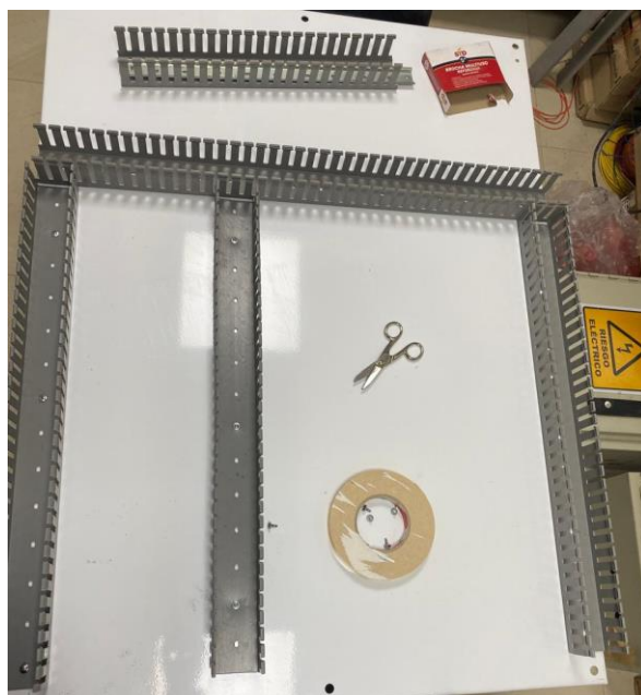
Fig. 17. Canaletas y riel din para colocar los componentes.
