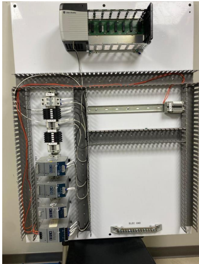
Fig. 19. Cableado de los componentes.
