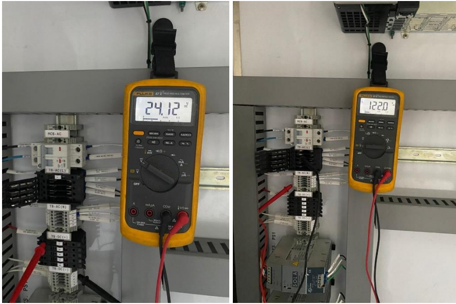
Fig. 13. Pruebas de señales eléctricas
