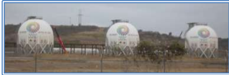
Figura 12: Esferas de almacenamiento de GLP que contendrán líquido presurizado, Fuente: FLOPEC.
