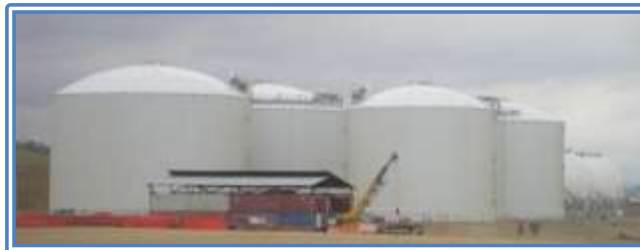
Figura 13: Tanques de almacenamiento criogénico de propano y butano. Fuente: FLOPEC.
