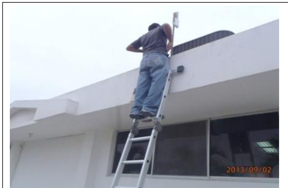
Figura 5.5 Nano M5 en Dpto. de sistemas Fuente: Implementación de tesis
