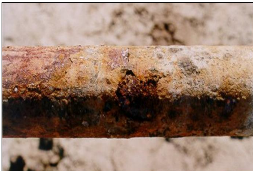
Anexo 3. Vista ampliada de una tubería atacada por la corrosión. Fuente: David Hernández. Corrosión en tuberías.
