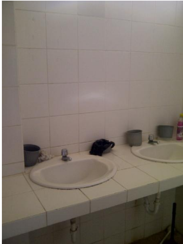
Tarrinas de comida en los baños
