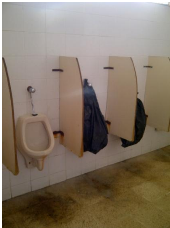
Urinarios baño de varones dañados
