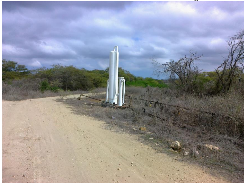
IMAGEN 75: Estación de extracción de gas
