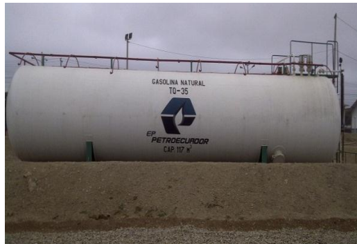
Figura 15. Tanque de almacenamiento vertical Fuente: Fotografía Refinería La Libertad Elaboración: Propia
