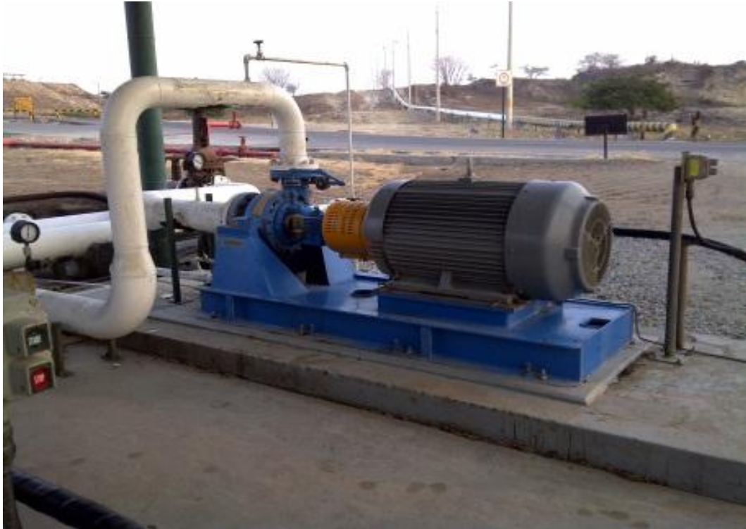
Figura 39. Bomba de la estación # 3 Fuente: Fotografía Refinería La Libertad Elaboración: Propia
