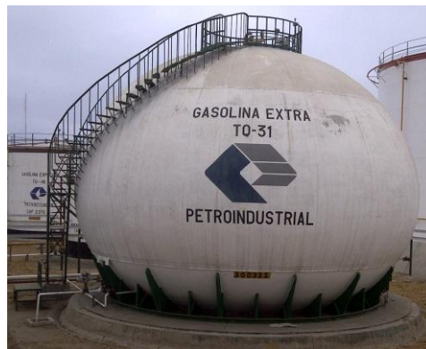
Figura 23. Tanques de almacenamiento esféricos Fuente: Fotografía Refinería La Libertad Elaboración: Propia
