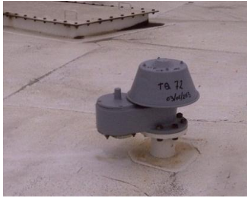
Figura 24. Válvula de presión tanque 72 Fuente: Fotografía Refinería La Libertad Elaboración: Propia
