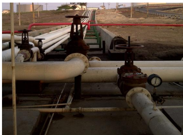
Figura 35. Válvulas de compuerta en estación #3 Fuente: Fotografía Refinería La Libertad Elaboración: Propia
