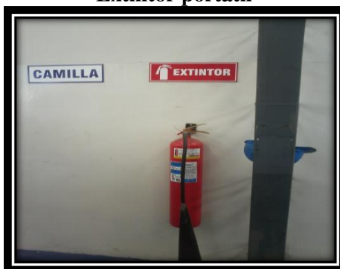
IMAGEN # 4 Extintor portátil
