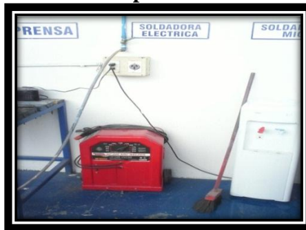
IMAGEN # 7 Señales de Aparatos Eléctricos
