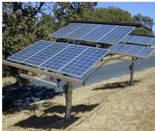
IMAGEN N° 3 SOPORTE DE PANELES
