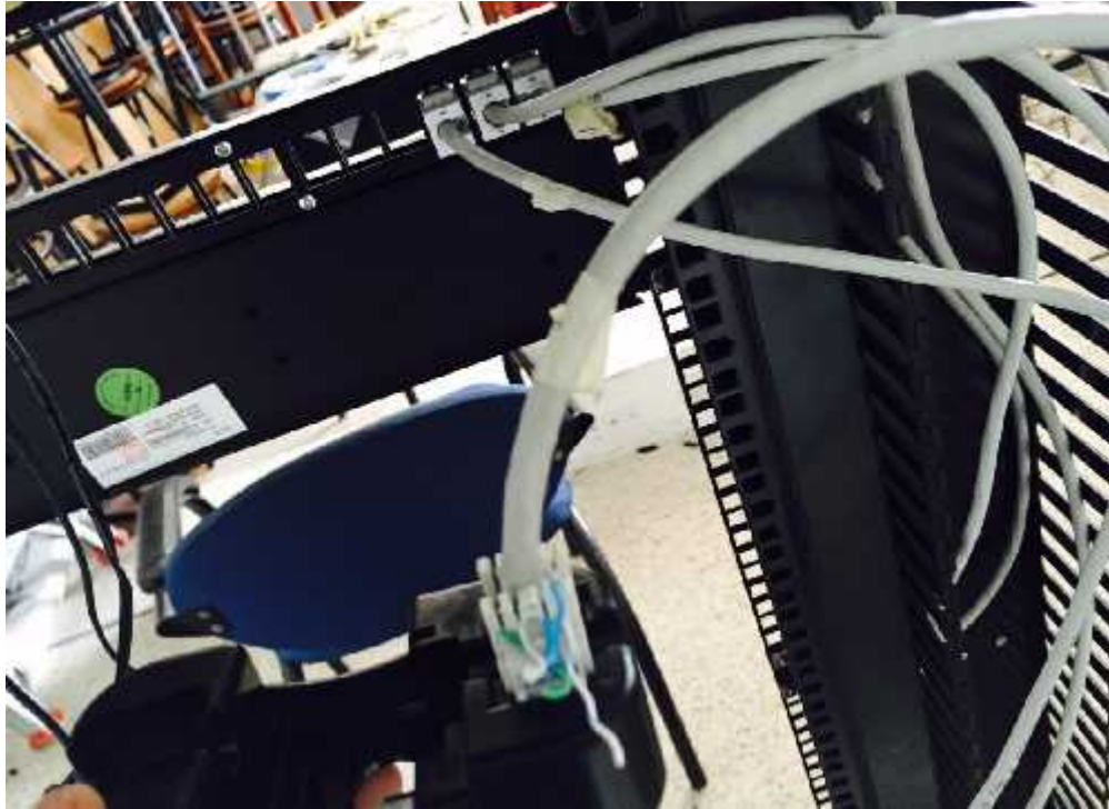
Anexo 7: Conexión de los cables en el Patch Panel
