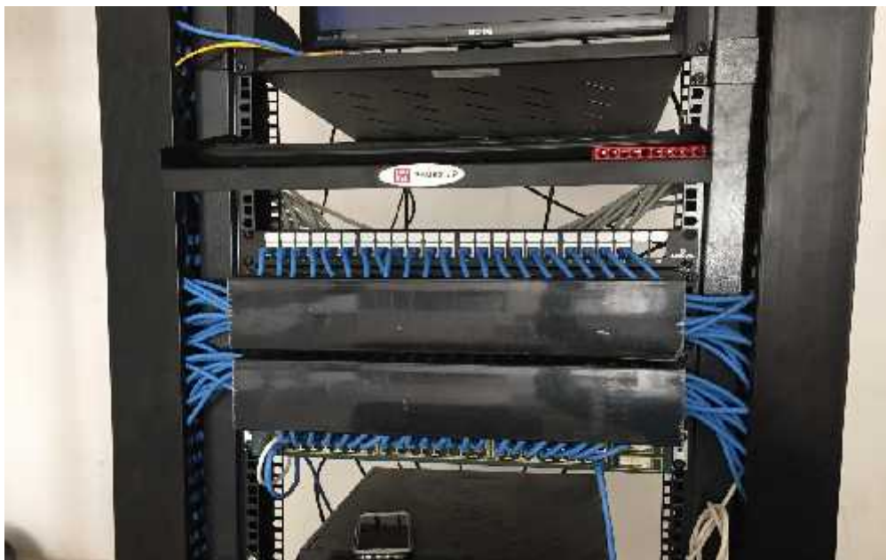
Anexo 8: Conexión finalizada del Patch Cord
