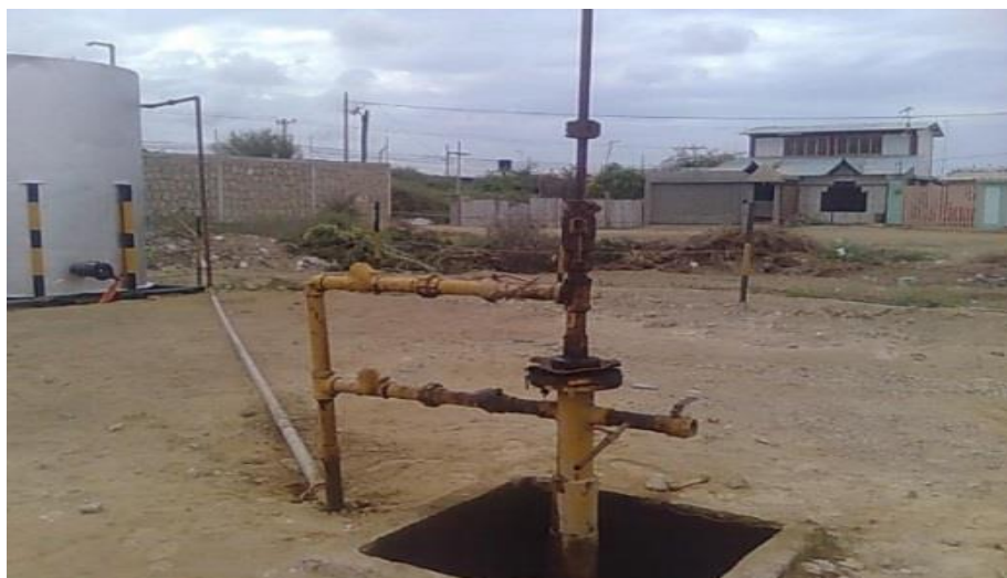
Fig.1.9. A. Tuberías de Transporte de Crudos
