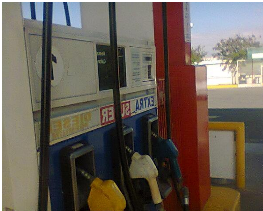
Maquinas despachadoras de combustible.
