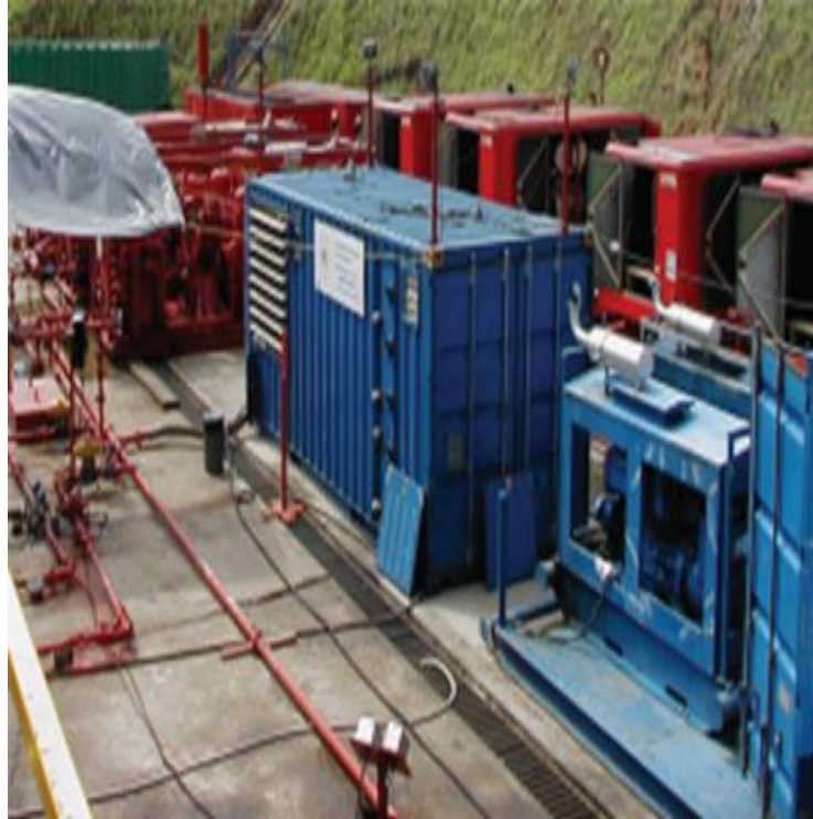
Figura 4.5.- Generador de nitrógeno y compresores en tierra. Fuente: Introducción a la Perforación Bajo Balance, Weatherford (Enero Del 2006).
