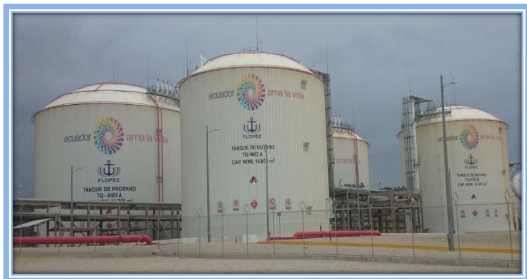
Figura 3 Tanques de Almacenamiento de Propano y Butano
