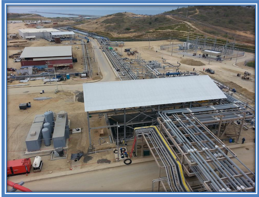
ANEXO 11. Parque de bombas
