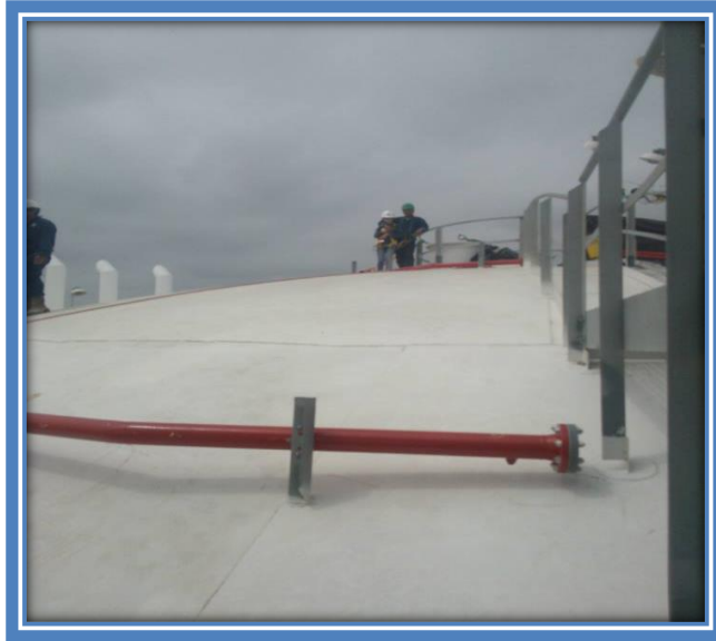
ANEXO 9. Parte Superior del Tanque Propano
