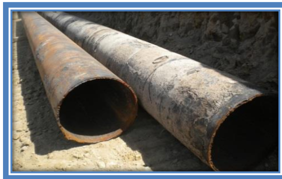
Figura 10 Tuberías de Gas con efectos de corrosión
