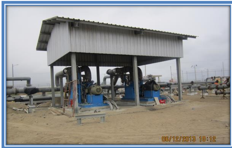
ANEXO 15. Bombas Booster
