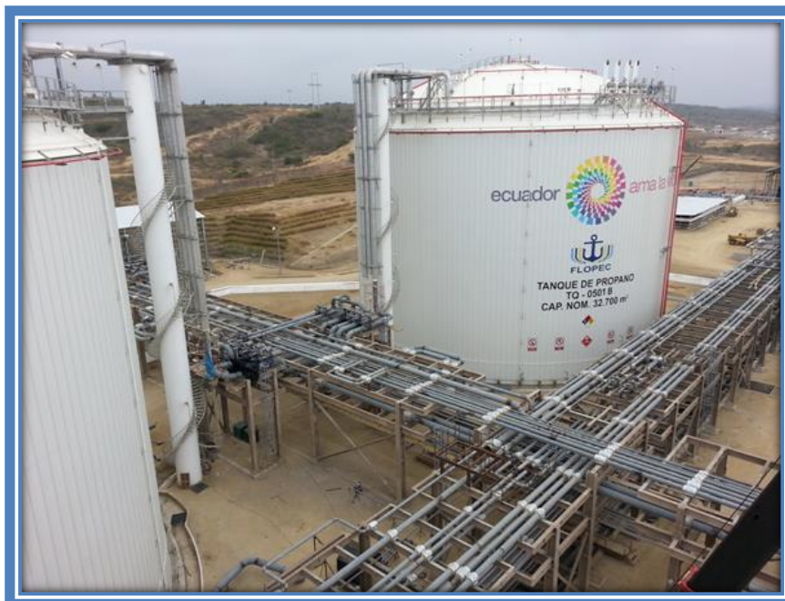
ANEXO 16. Pipe rack y Tanques
