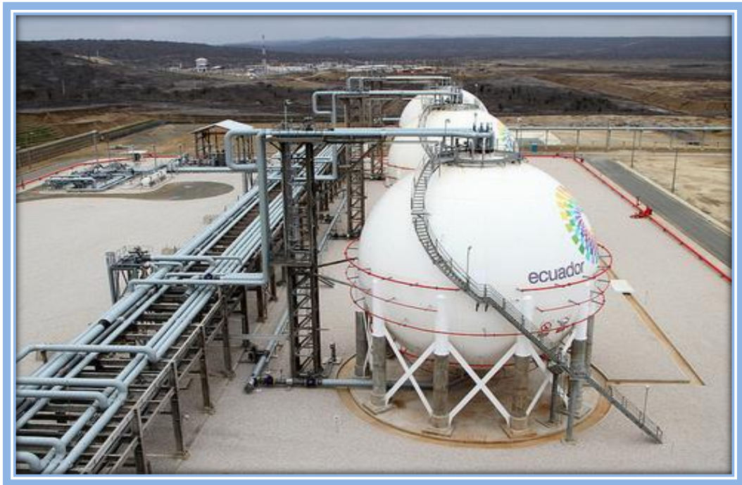
Figura 5 Esferas de Almacenamiento de GLP
