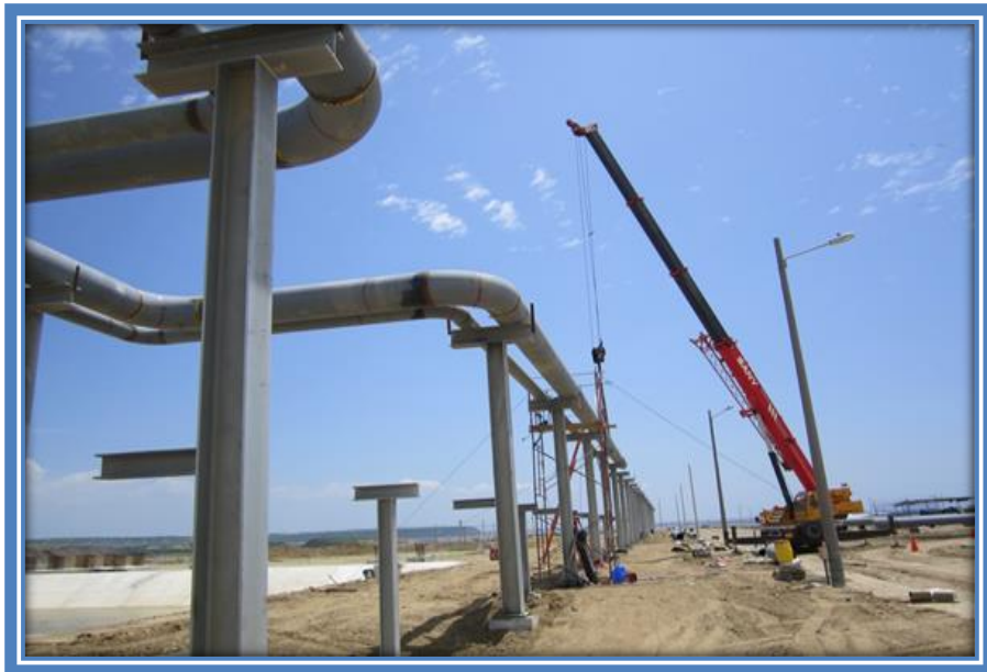
ANEXO 12. Tubería en aire al flare
