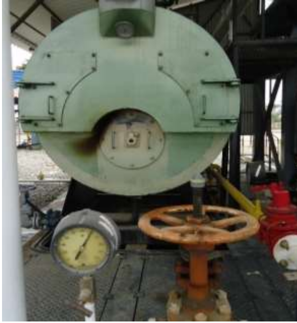
Figura 29: Caldero de la Planta de Gasolina (vista frontal).
