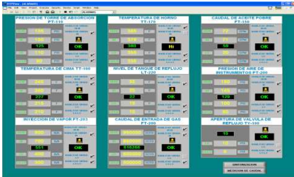
Figura 11: Ventana de Alarmas.
