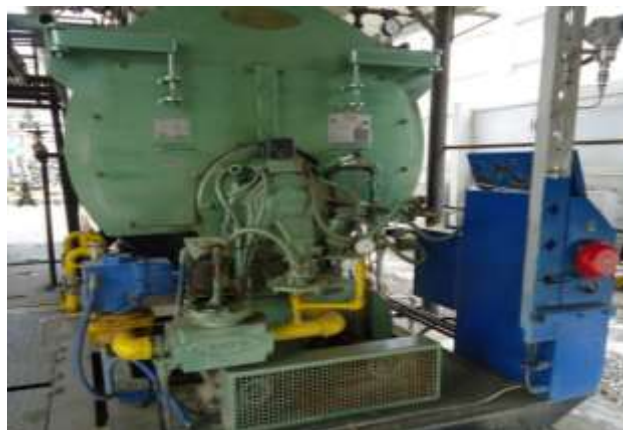
Figura 28: Caldero de la Planta de Gasolina
