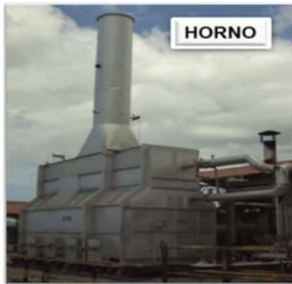
Figura 27: Horno de la Planta de Gasolina.
