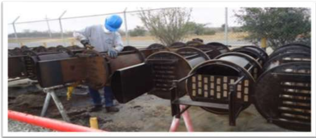
Figura 18: Módulos de la Torre de Absorción.
