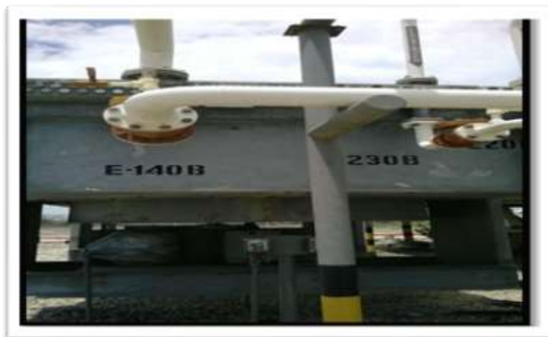
Figura 26: Aeroenfriadores de aceite, gasolina de reflujo y natural
